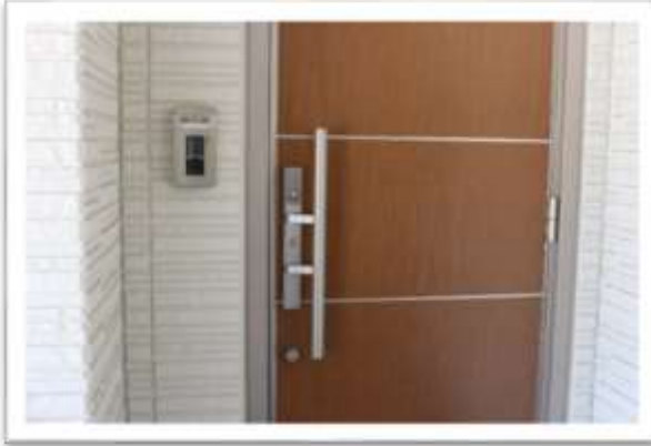
玄関 *カードキーで施錠
